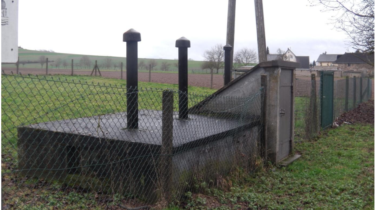
Das neue Pumpwasserwerk M. N. 11.02.21
